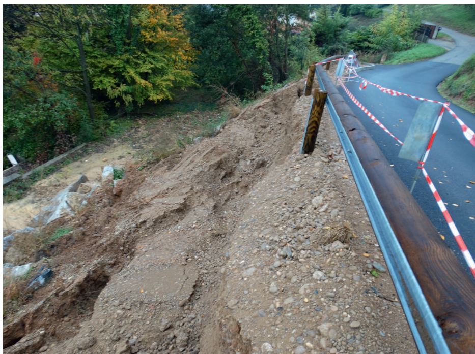
Effondrement de la route des Pends
